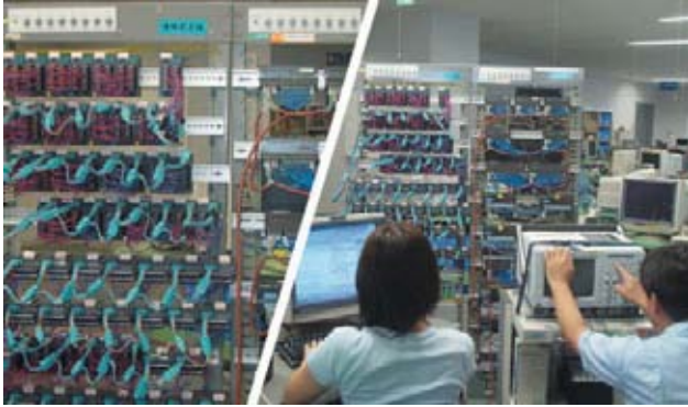
■接続対応製品の急速な増加を支える、コンフォーマンステスト。
